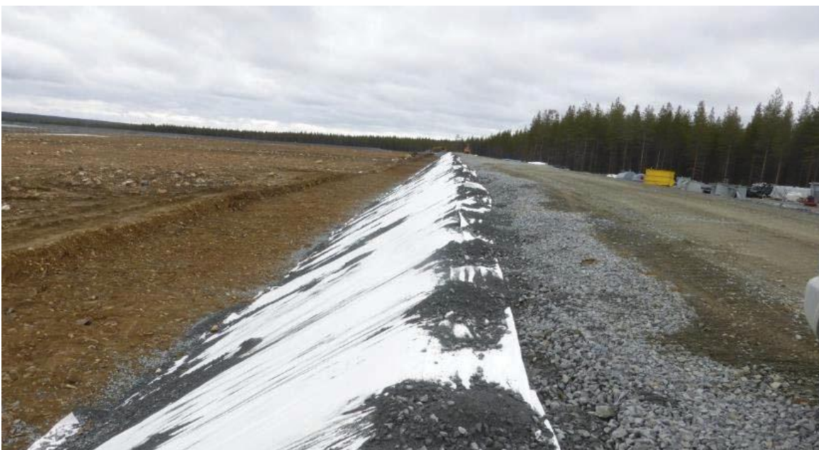
Kuva 28. Länsireunan tiivisteuran pohja on kaivettu ja luiskasuodattimen päälle on asetettu N3 luokan suodattinkangas. Mitatut limityspituudet olivat yli 500 mm.
