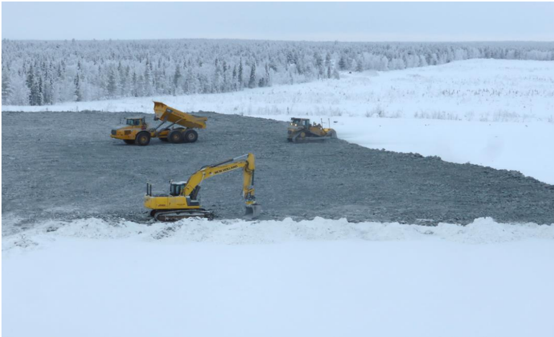
Kuva 9-2. Sivukivialue 1b luoteisreunan louhe oli laatuvaatimusten mukaista. Valmiin louherakenteisen suojakerroksen kerrosvahvuus oli yli 2,0 metriä.
