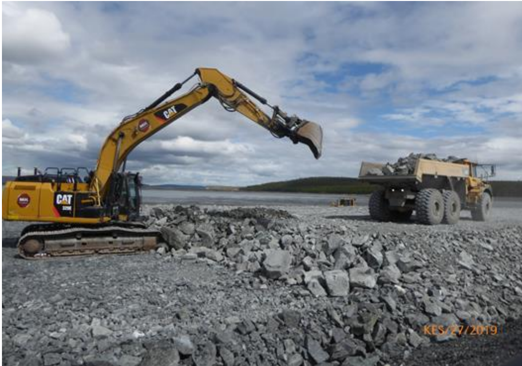
Kuva 9-2. Rikastushiekka-altaan vaiheen 5 louheen levitystä tehtiin puskutraktorilla ja kaivinkoneella. Louherakenne tiivistettiin kaistoittain täyteen lastatuilla 60 t maansiirtoautoilla.
