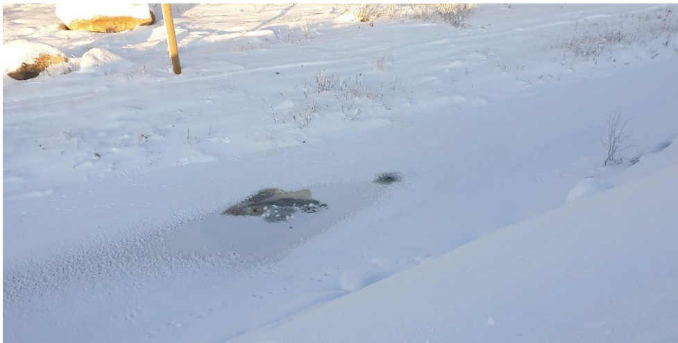
Kuva 3: Tihkumista havaittu kehäkeräyskanavassa (noin kj 5+900 kohdalla) /
