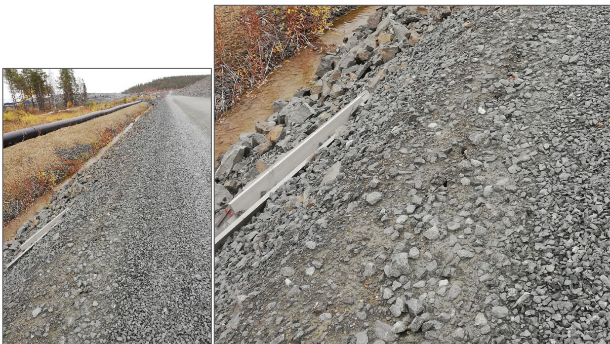
Kuva 15: Halkeamia altaan A pohjoispuolella huoltotien reunassa. / Cracks in the shoulder of the service road on the northern side of TSF A.
