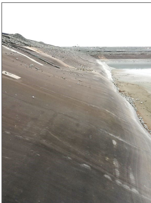
Kuva 16: Pullistuma tiivistyskalvossa altaan B eteläisen padon luiskassa. / Bulge in the sealing membrane of TSF B southern dam.
