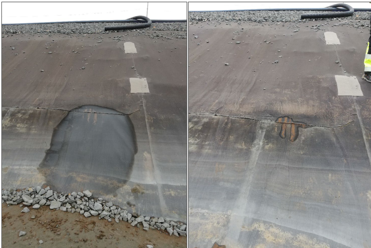
Kuva 17: Vettä vuotaa altaan B eteläisen padon tiivistyskalvon läpi. Vasen kuva 30.9.2021 aamulla noin klo 8 ja oikea kuva pari tuntia myöhemmin. / Water is leaking through the sealing membrane of TSF B. Left picture was taken on the 30th of September 2021 at around 8 o'clock in the morning and the right picture about two hours later.
